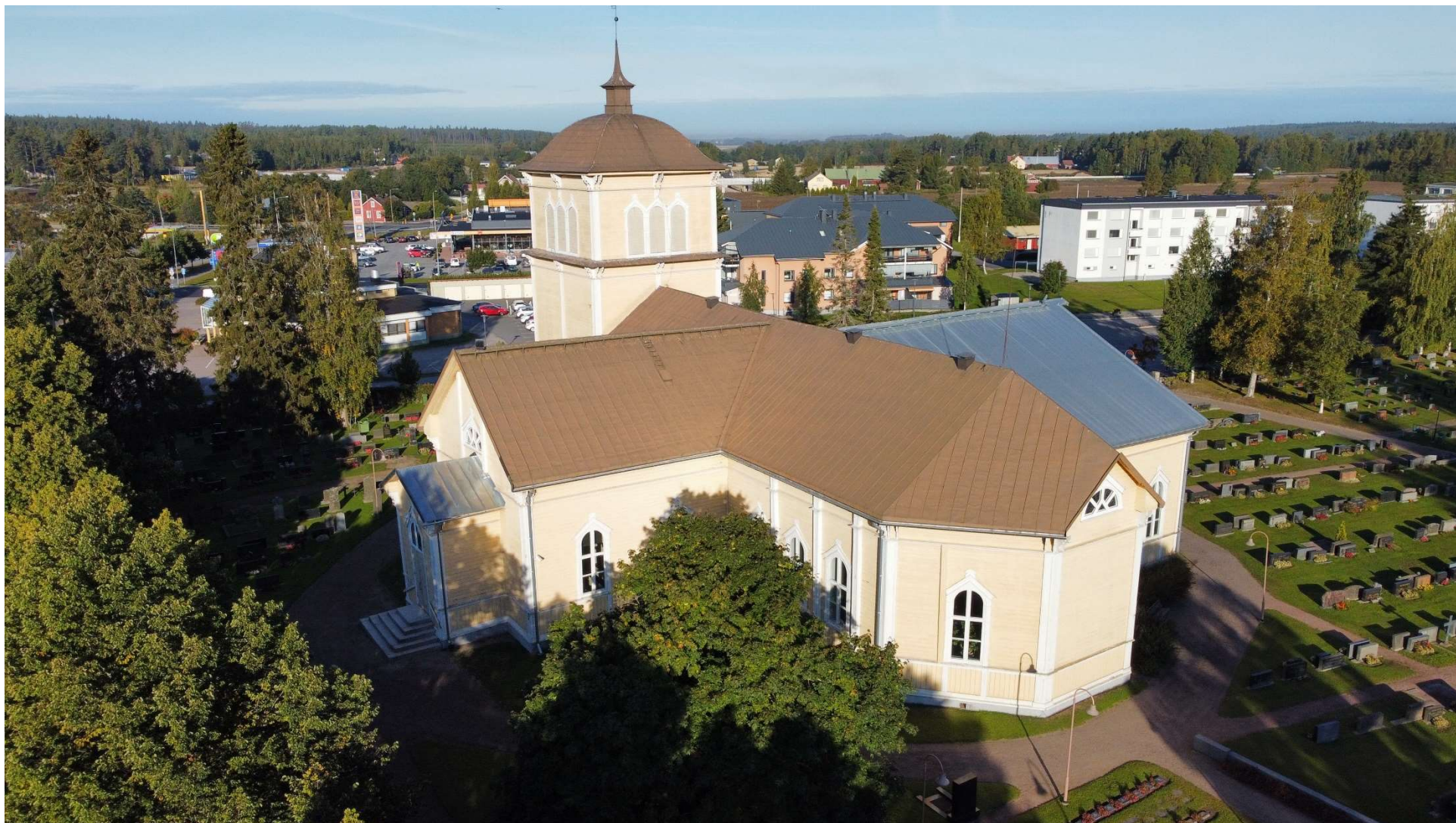
Kustaa Aadolfin kirkko kuvattuna kaakosta keväällä 2023 ennen kesän peltikaton uusimistöitä. Kuvassa oleva ruskea peltikate on asennettu 1800-luvun lopussa tai 1900-luvun alussa, tornin kate ilmeisesti jo aiemmin. Kiiltävät lappeat pohjoisessa ja eteläisen kuistin päällä on vaihdettu jo aiemmin.
